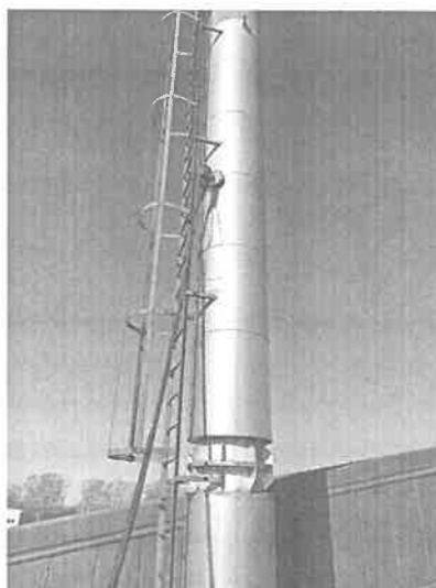
Merno mesto – Emiter kotla 1
