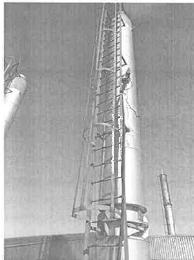
Merno mesto – Emiter kotla 2
